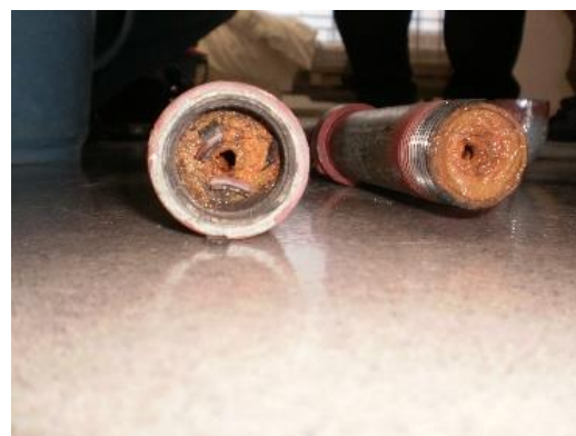
蒸気用ドレンの詰まり
