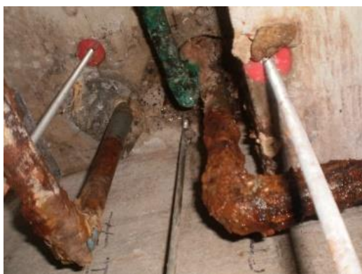
給湯管の腐食
