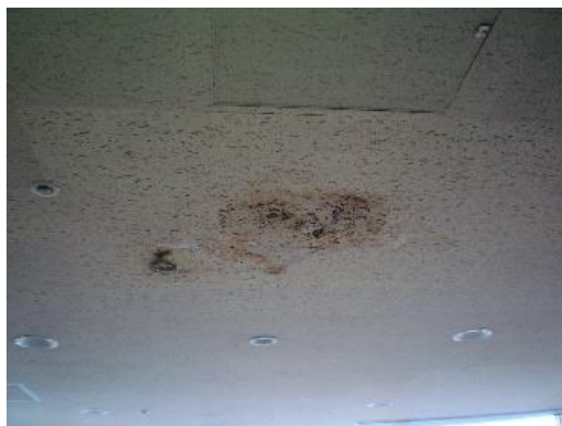
雨漏りによる天井の変色
