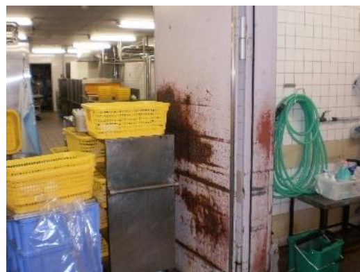
厨房扉の腐食
